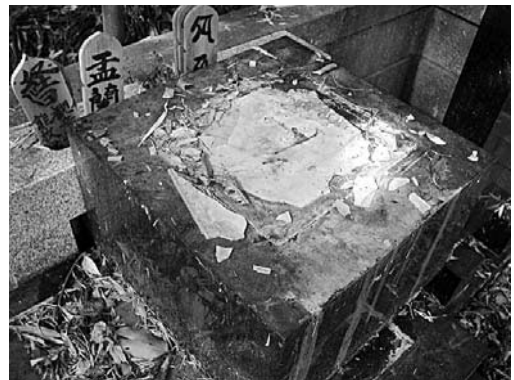
「生セメントは絶対にくっつかない」と小川氏 (新潟県中越地震の被災地にて編集部撮影)
